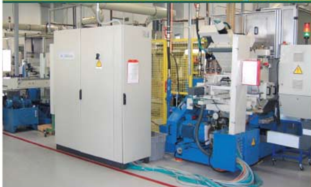
L'impianto fornito da Ghiringhelli a CWG
